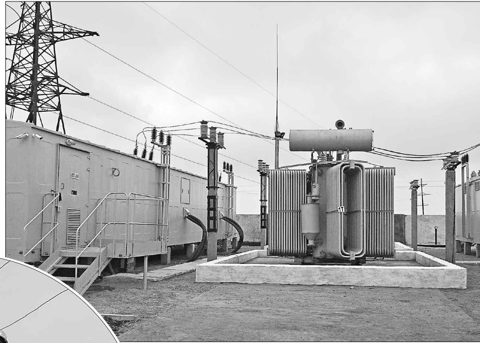
Надсучасна ПС 35-6 кВ імені В. Ягодина з обладнанням контейнерного типу фірми «АВВ»
