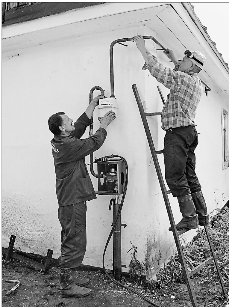
Прилади обліку сприяють заощадженню енергоресурсів
