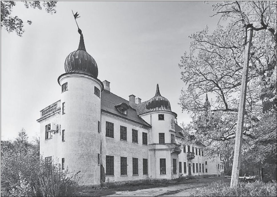
Палац уже більше не може чекати реставраторів-ремонтників
