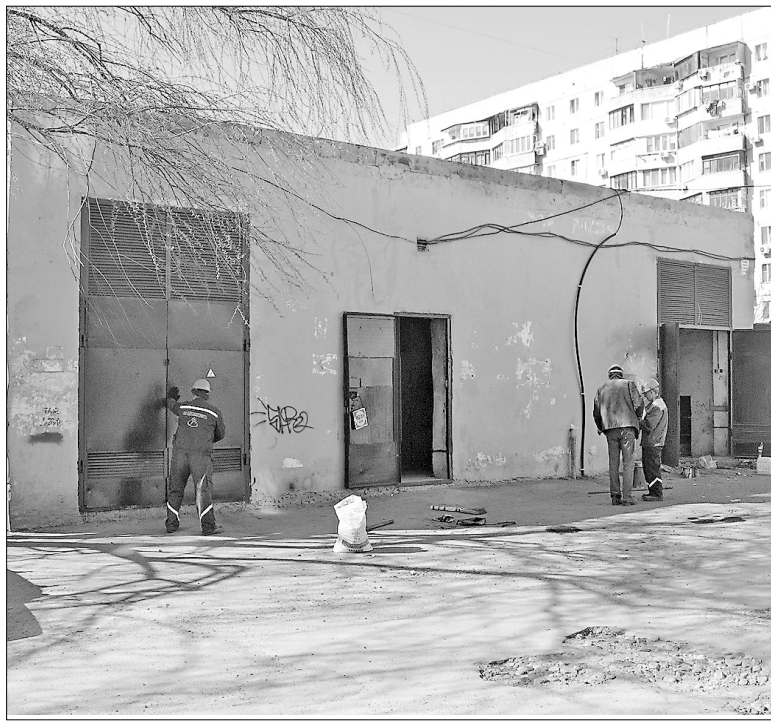
Кількагодинні відімкнення струму через аварійний ремонт — не рідкість
