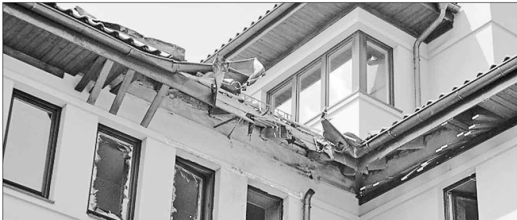
Снарядом зруйновано покрівлю та балку над дитячими кімнатами у будинку Андрія Садового
