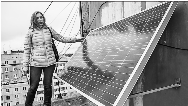
Керівник фірми-підрядника Руслана Пушкарська демонструє сонячну міні-електростанцію на даху дев'ятиповерхівки, електрика якої освітлює сходи, тамбури та технічні приміщення будинку. Тепер мешканцям електроенергія обходиться у 77 разів дешевше
