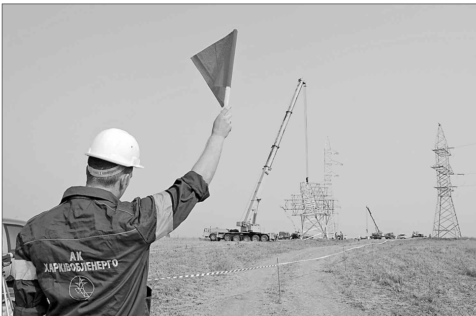
У 2010 році було здано в експлуатацію повітряну лінію 110 кВ «Перемога — Дергачі»
