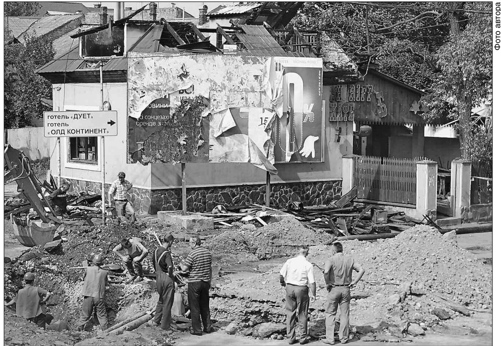
Тривають роботи на місці аварії
