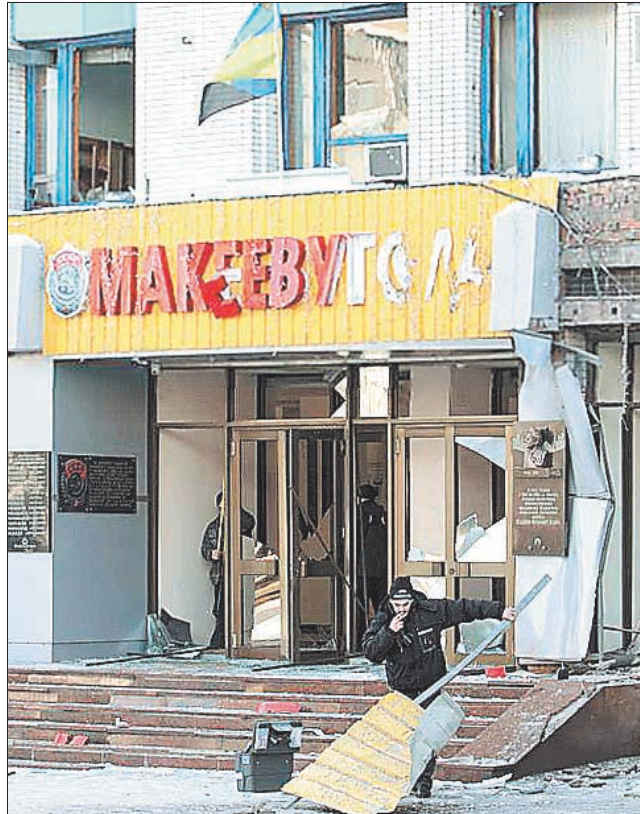
Фасад адмінбудинку ДП «Макіїввугілля» доведеться ремонтувати
