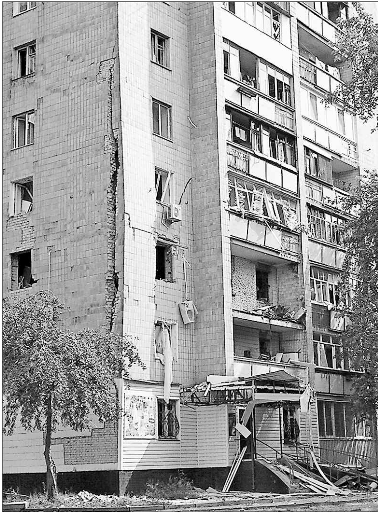
Зовнішня стіна будинку ледве тримається, а тріщина збільшується
