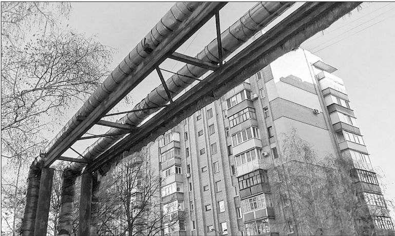
Щоб тепло, яке йде трубами від котельні до будинку, гріло людей, а не повітря, треба подбати про ізоляцію труб
