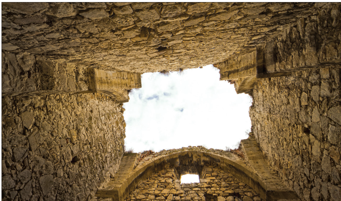
Нині фундамент та стіни Докової вежі руйнуються внаслідок будівництва причалу в безпосередній близькості до історичної пам'ятки
