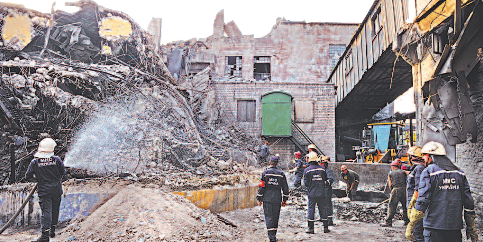
Копер давно потребує капітального ремонту
