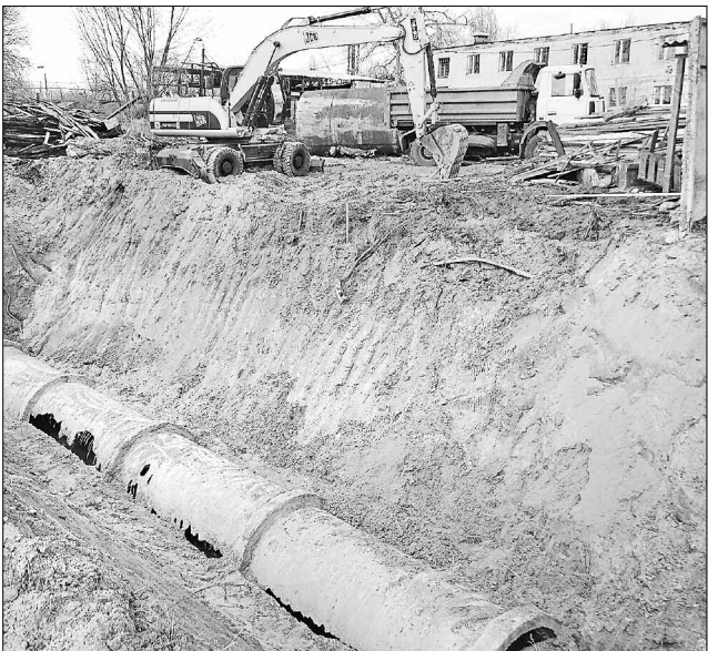
Такий вигляд має аварійна ділянка
