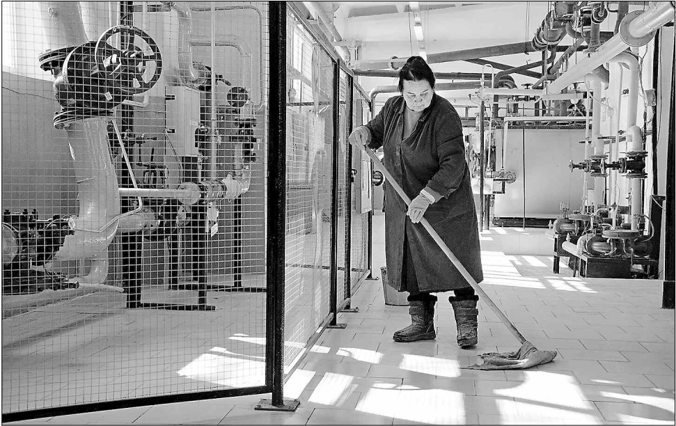
Модернізовані котельні слід тримати в чистоті
