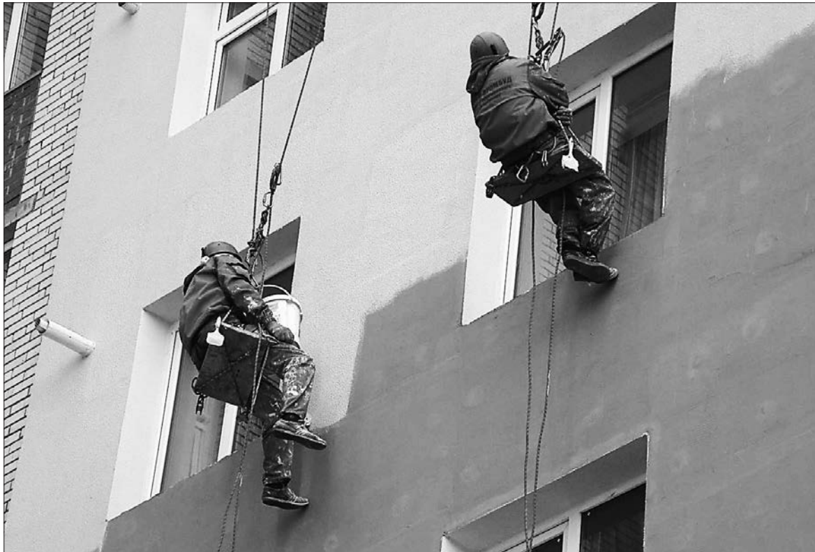
Монтажники під час утеплення будинків не завжди дотримуються вимог технології
