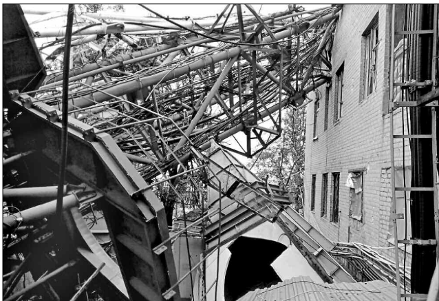
Знищене обладнання стільникового зв'язку
