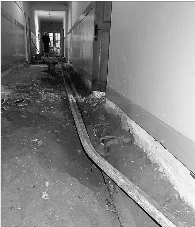
Такий вигляд має горезвісне приміщення з аварійними трубами
